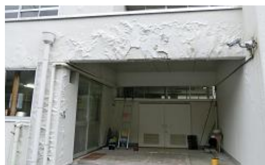
佐見小学校の外壁塗装等の劣化 外壁塗装と屋根の防水シートの劣化により雨漏りが発生していたが平成28年度修繕済み
