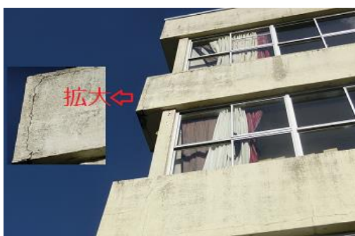
白川中学校の外壁モルタルのクラック モルタルの破片が落下したが平成30年度修繕済み
