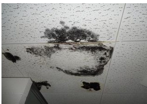
佐見小学校プール更衣室の雨漏り 屋根の防水シートの劣化により雨漏りが発生していたが平成28年度修繕済み
