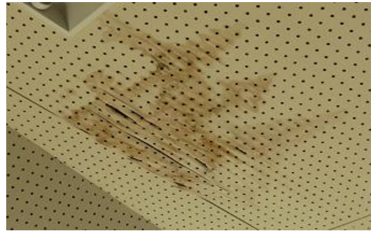
黒川小学校音楽室の雨漏り 左の写真に示した防水シートの劣化等により雨 漏りが発生しているため令和2年度修繕予定
