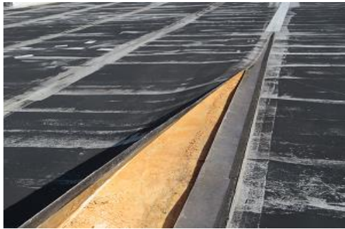
黒川小学校屋上防水シートの劣化 防水シート及び屋根スラブコンクリート が劣化しているため令和2年度修繕予定
