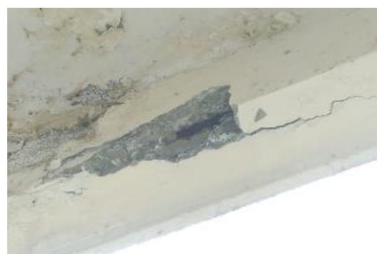
黒川小学校ベランダコンクリート落下 内部の鉄筋がさび膨張したことでコンクリートが落下したが平成30年度修繕済み
