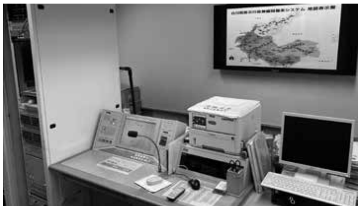
現在の役場防災行政無線室
