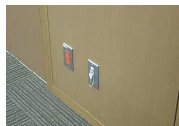
非常用電源設備の例
