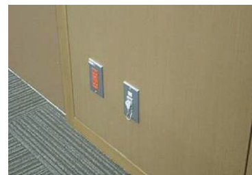
非常用電源設備の例
