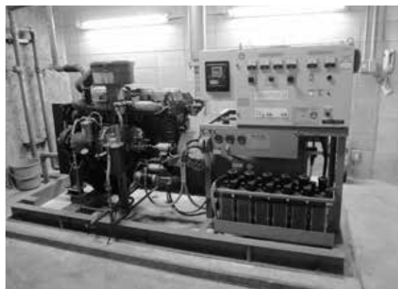
町民会館の自家発電設備
