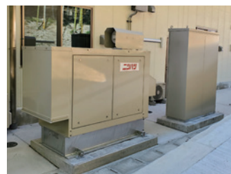
非常用発電設備
